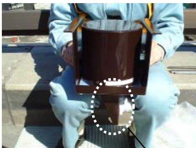
(a)制振装置取り付けジグ
